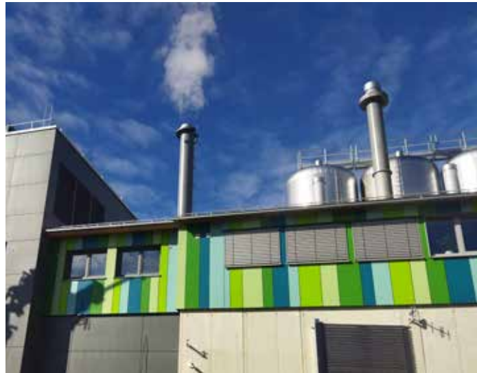
Weißer Rauch steigt über dem Dach der KUMS-Heizzentrale auf – auch hier ein gutes Zeichen.
